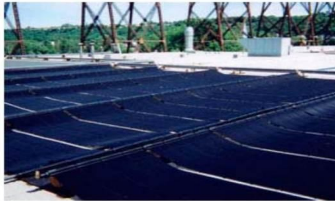
Figure 22. Capteurs solaires non vitrés à revêtement sélectif. [53]
