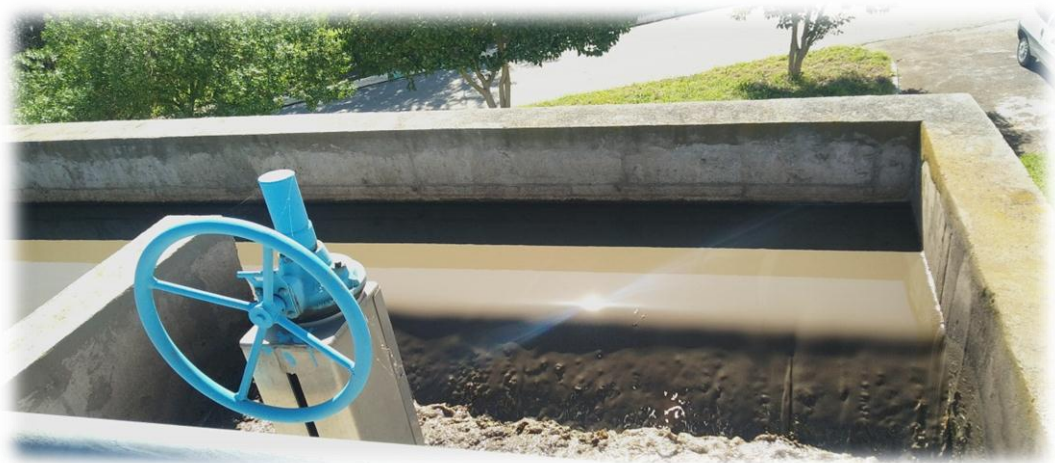
Figure(46) : Point de prélèvement des boues recirculées.
