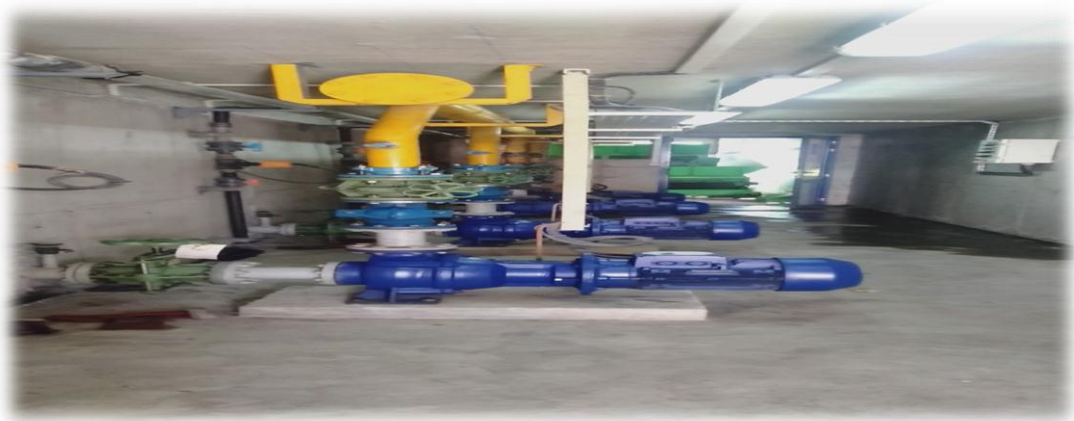
Figure (24) : Pompe à sable.
