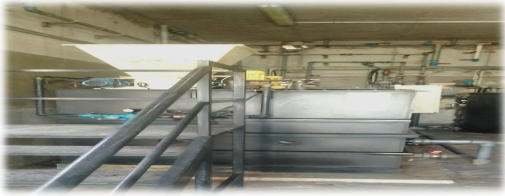
Figure (35) : Logement de Préparation du polymère.
