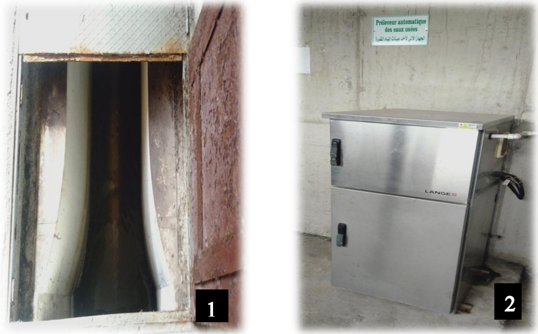
Figure (43) : Prélèvement à L’entrée (1 : point de prélèvement après dégrilleur fin ; 2 : préleveur automatique des eaux brut).
