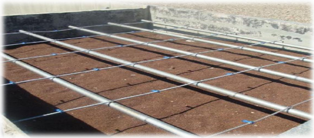
Figure (39) : Désodorisation biologique.
