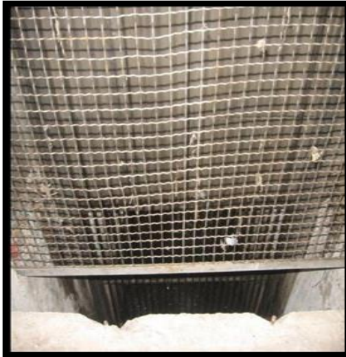
Figure 10 : dégrilleur fin manuel
