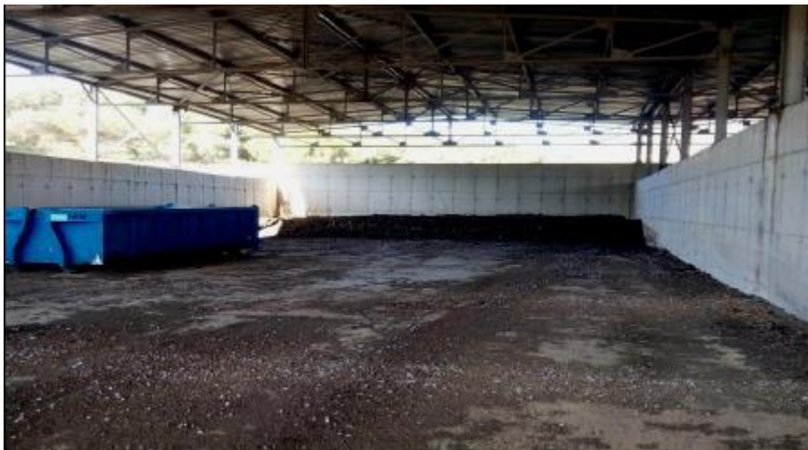
Figure 19 : Aire de stockage des boues séchées
