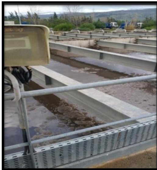
Figure 12 : bassin d'aération (zone aérobie)
