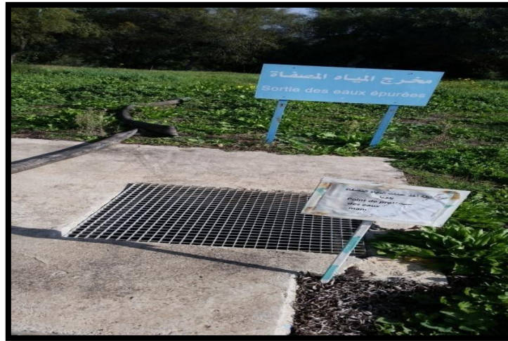
Figure 14 : les eaux épurée a la sortie de la station (STEP)
