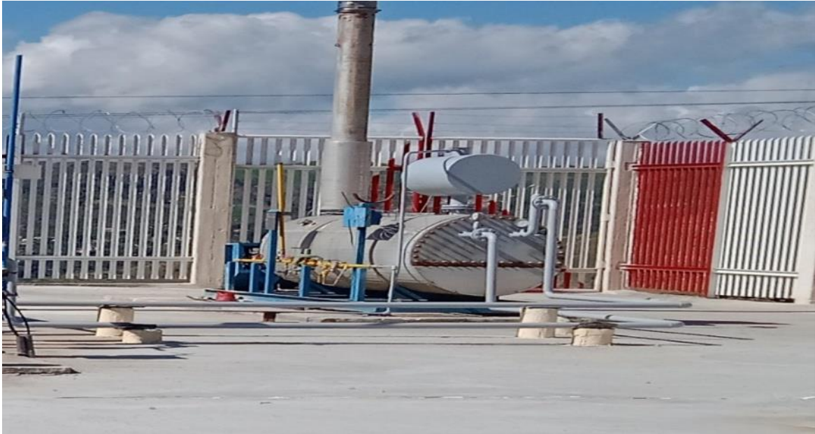
Figure I.11: Réchauffeur de poste détente DP Tassadane Haddada (W. Mila).
