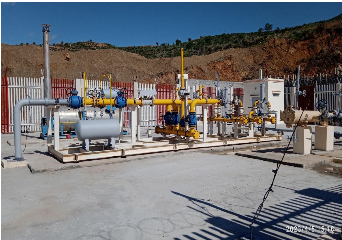
Figure V.4 : poste de détente DP Tassadane Haddada capacité 5000Nm 3 /h (W. Mila).
