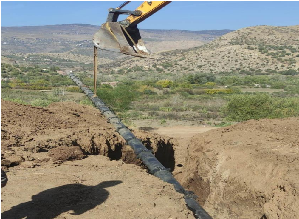
Figure IV.5 : Traversé de route Mechta Bouchakouf avec un canal des égouts (Pk : 2+009.24).
