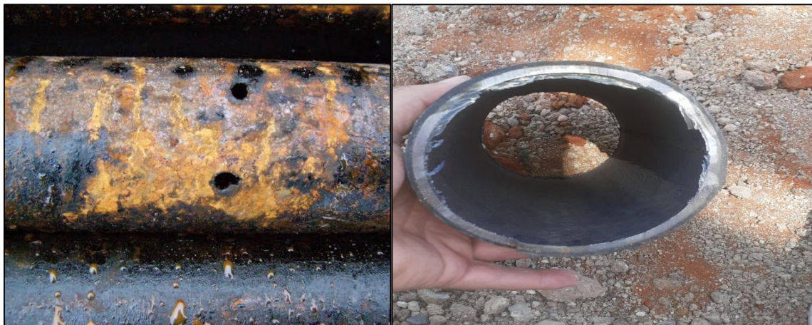
Figure I.9 : Conduite d'acier corrodée.
