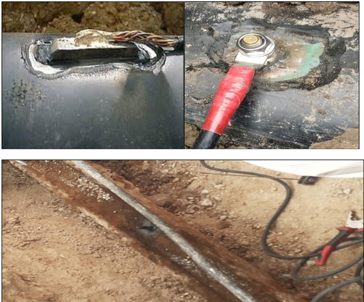
Figure II.7 : Les câbles de liaison (conduite, déversoir).
