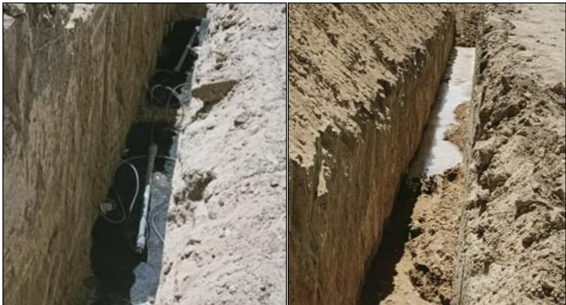
Figure II.5 : Le milieu entourant l'anode sacrificielle en Ferro-silicium.
