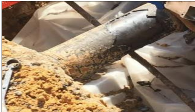
Figure I.12: Décollement de revêtement de Conduite d'acier.
