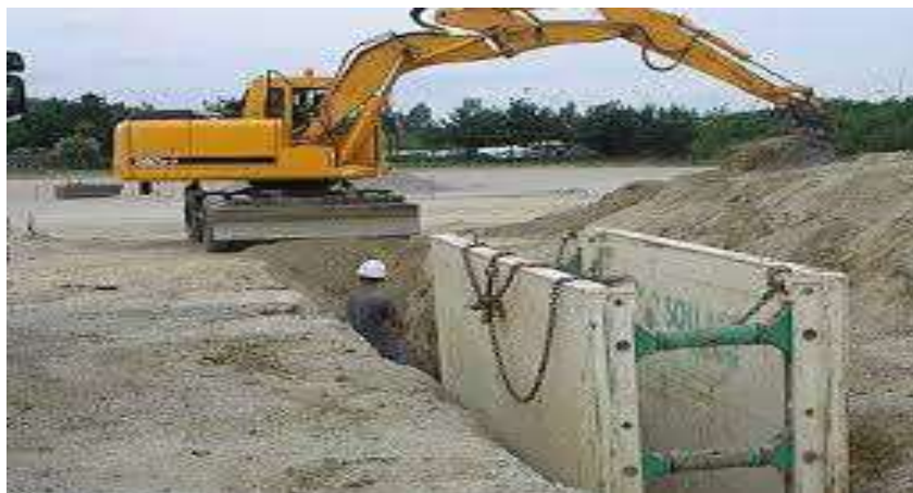
Photo 5 : Sécurité contre l'effondrement
