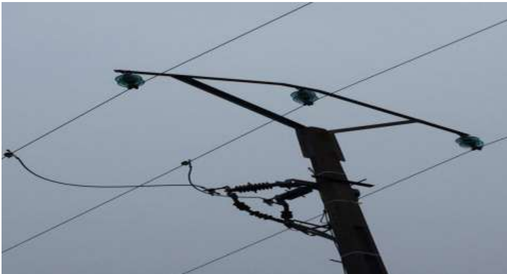
Figure I.2 : ligne basse tension
