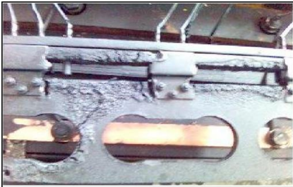
Figure II .1 : Défaut suite au mauvais serrage sur borne BT[7]
