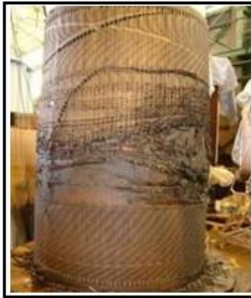
Figure II .4 : Amorçage diélectrique entre spire[5]
