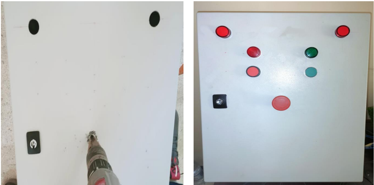
Figure 3.18 : La face de l'armoire électrique
