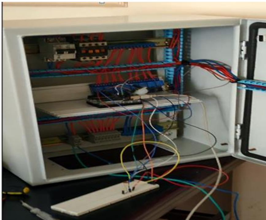
Figure 3.21 : Test de l'armoire électrique avec le capteur de mouvement et LDR.
